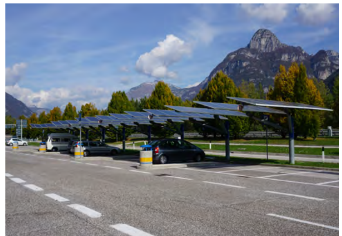
Abb. 70: Mit PV-Anlagen verschattete Parkplätze, Trentino (IT) [1]
